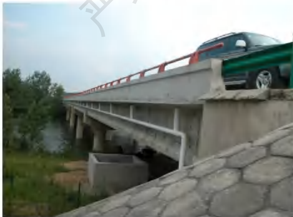
图 5.4.8-2 湖北孝襄高速陨水河桥面径流收集装置
